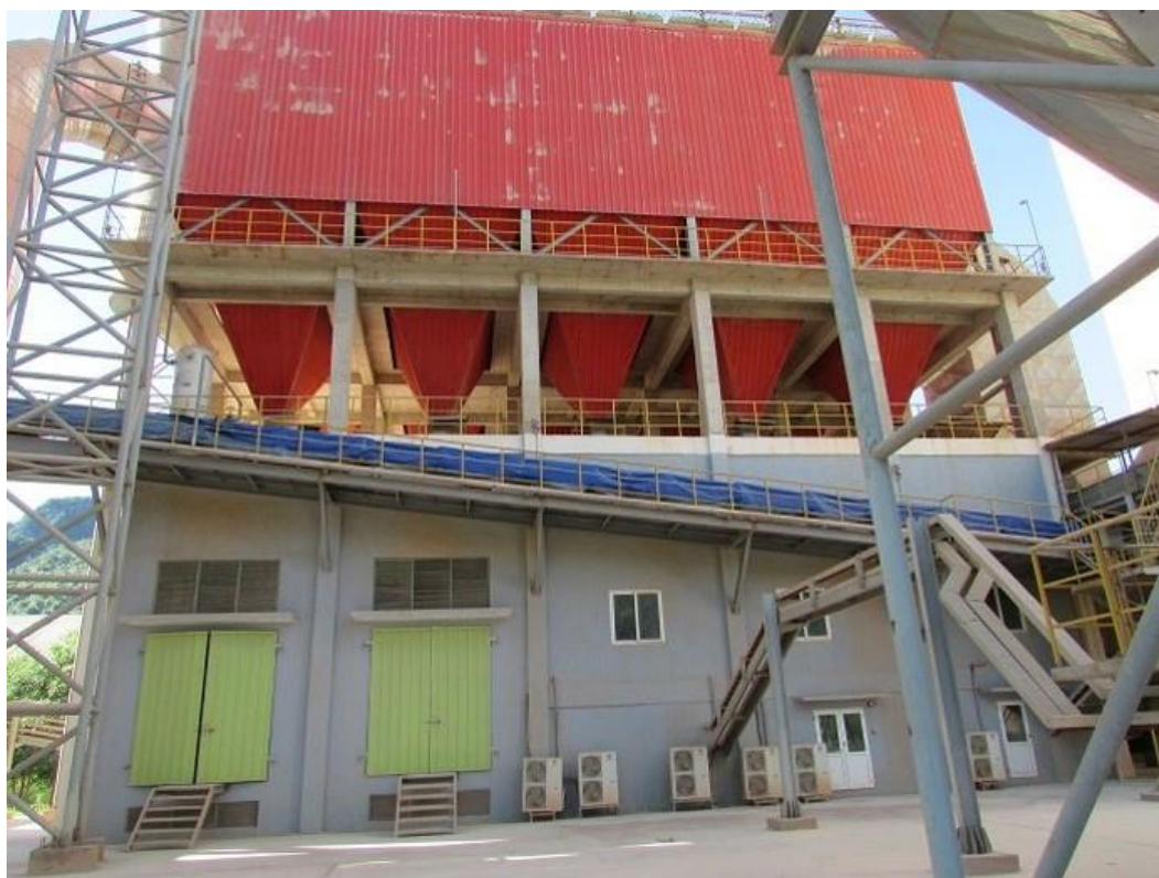
Hình 14. Hình ảnh thiết bị lọc bụi trong dây chuyền sản xuất Clinker
