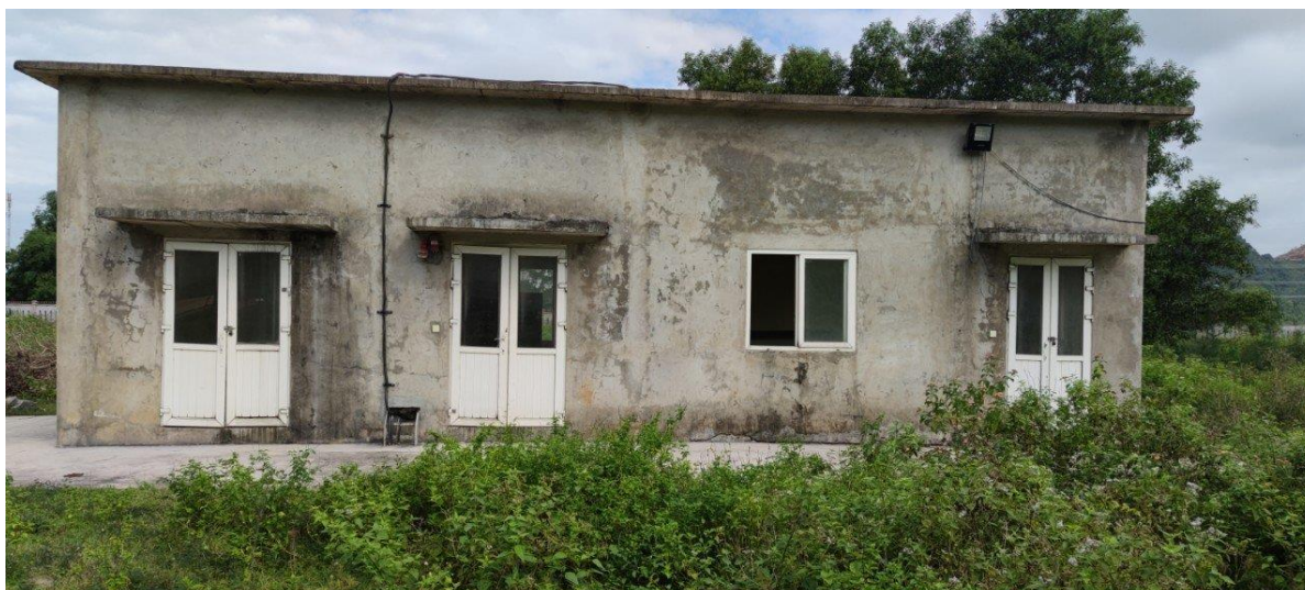
Hình: Nhà điều khiển trạm xử lý nước thải tập trung
