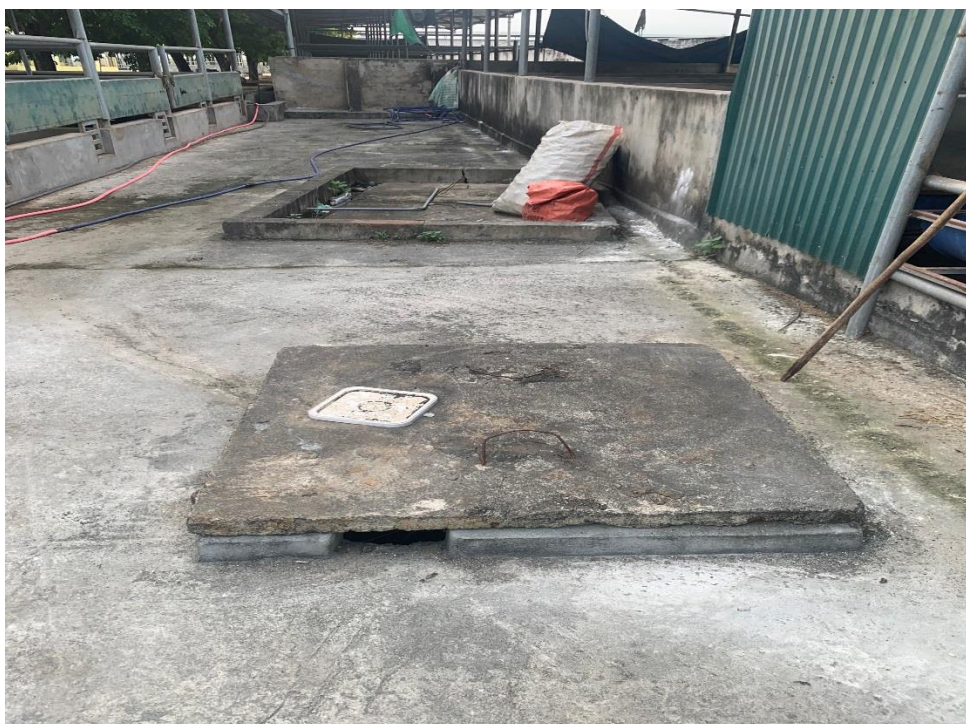
Hình 3.5. Bể xử lý kỵ khí xây ngầm
