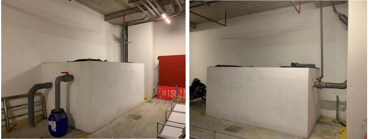
Hình ảnh: Bể tách dầu mỡ khoáng của xưởng dịch vụ VinFast
